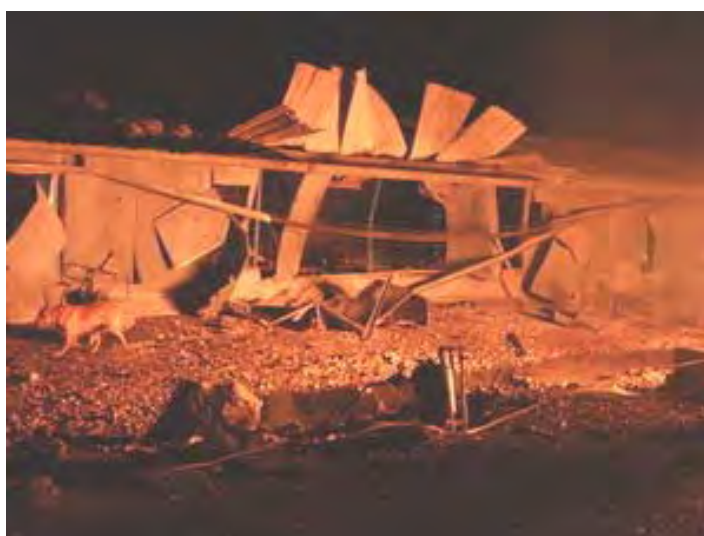
נזק שנגרם כתוצאה מירי אחת הרקטות לעבר הגליל המערבי (באדיבות NRG, 29 בנובמבר 2011. צילום: מקס ילינסון)
