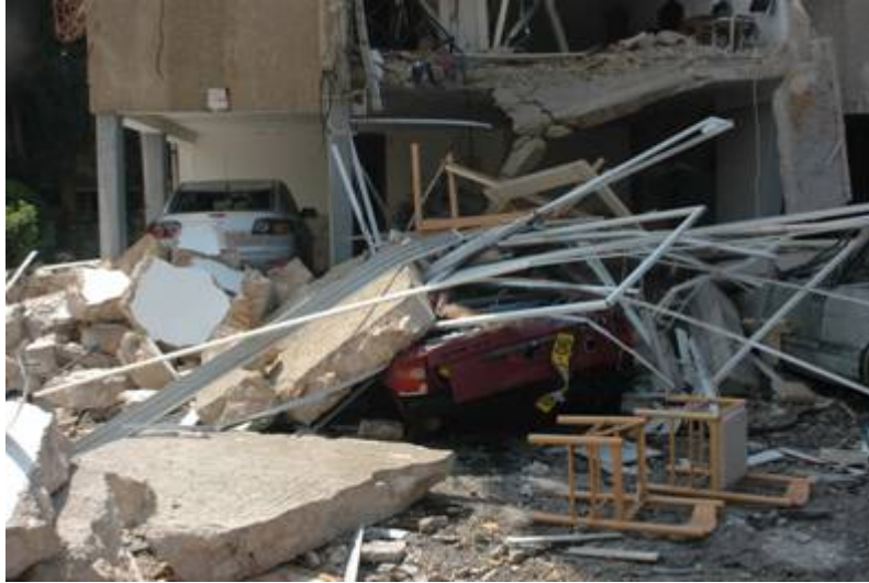
Maison de Haïda détruite par une roquette (Photo publiée avec l'aimable autorisation de la Police israélienne)
